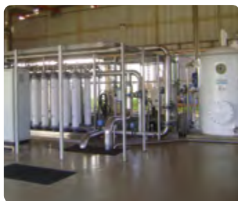
FEMSA / PR Ultrafiltração 95 m 3 /h
