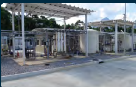
Coca-Cola / RJ Sistema de Reúso de Efluentes 20 m 3 /h
