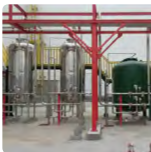
AmBev / RJ ETA 30 m 3 /h
