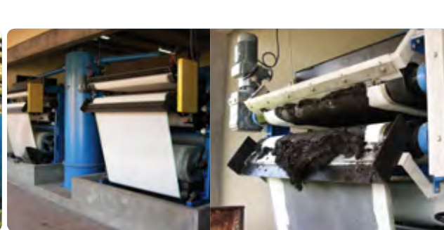
Sadia / MG Sistema de Desidratação de Lodo
