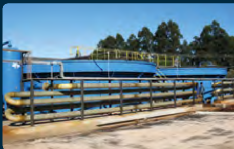
Sadia / MG ETE 900 m 3 /h
