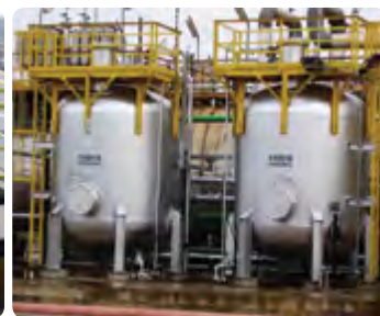
Replan Petrobras / SP Filtros Decloradores 150 m 3 /h
