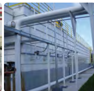
Coca-Cola / PE ETA 200 m 3 /h
